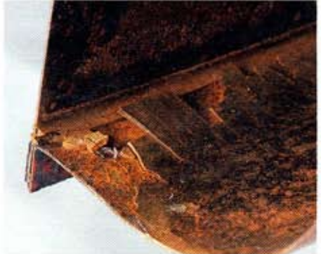
Fertans neues Nanoprodukt NT10 lagerte sich am Schwellerboden ab und bildete Risse
